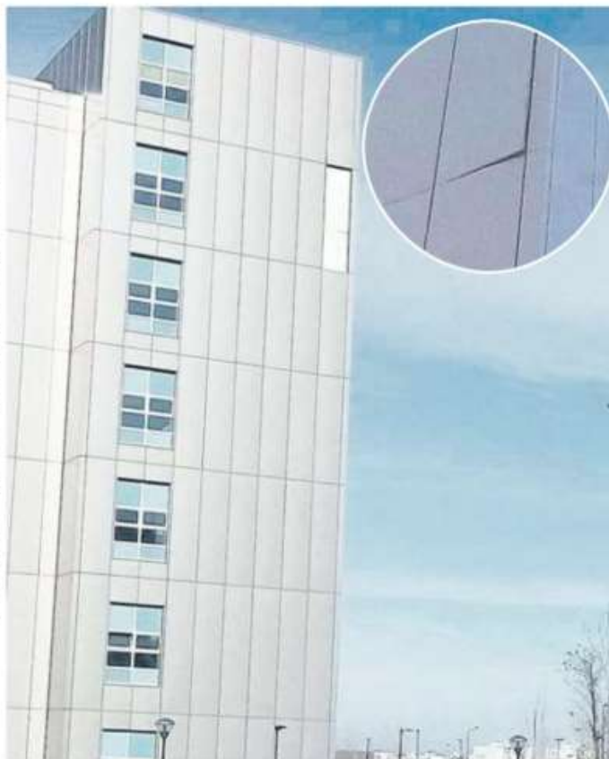
L'INCIDENTE Una delle facciate da cui si è staccato il pannello. Nel cerchio il momento del distacco
