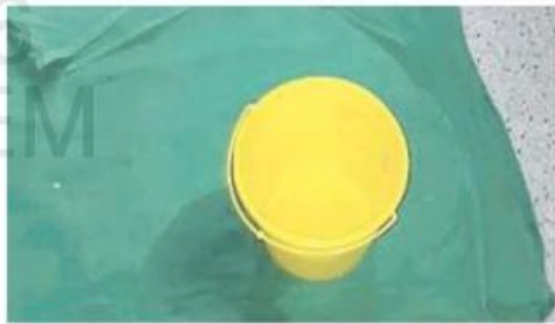
LE INFILTRAZIONI Secchi d'acqua al terzo piano negli ambulatori
